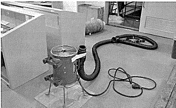
投葉ホースの設置状況
